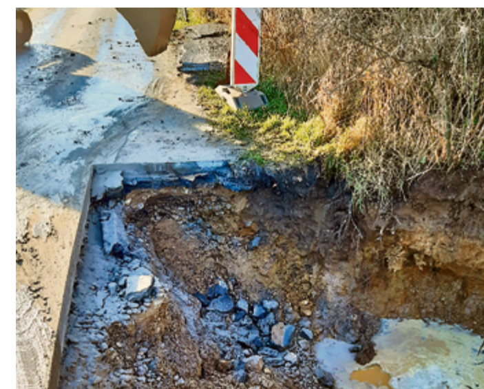
Das Wasser hatte beim Rohrbruch die Straße unterspült, die Stelle wurde großflächig ausgebessert.
