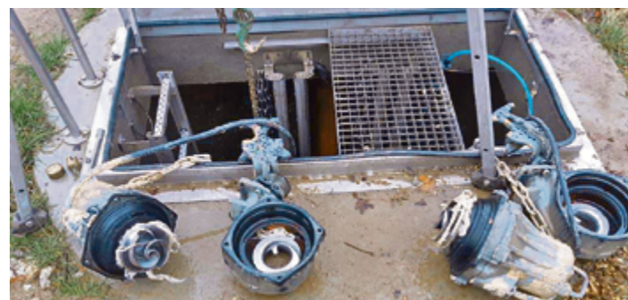
Die reißfesten Fasern von Feuchttüchern lösten sich im Abwasser nicht auf und wickelten sich im Neubaugebiet Husby um die Pumpen, deren Arbeit dadurch empfindlich beeinträchtigt wurde.
